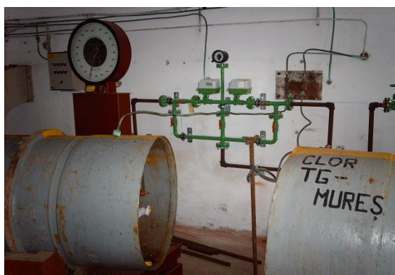
Stația de clorare
