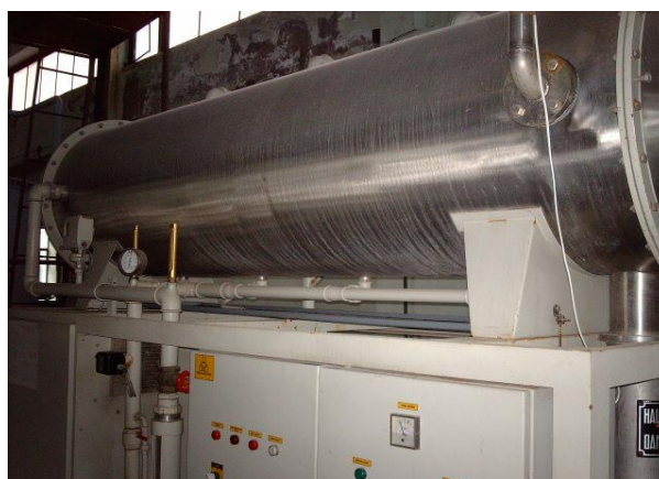
Instalație de ozon
